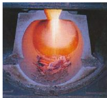
Bilde av kjelens etterforbrenningskammer og den blå/orange flammen som er kjenne-tegnet på totalforbrenning av røkgassene.
